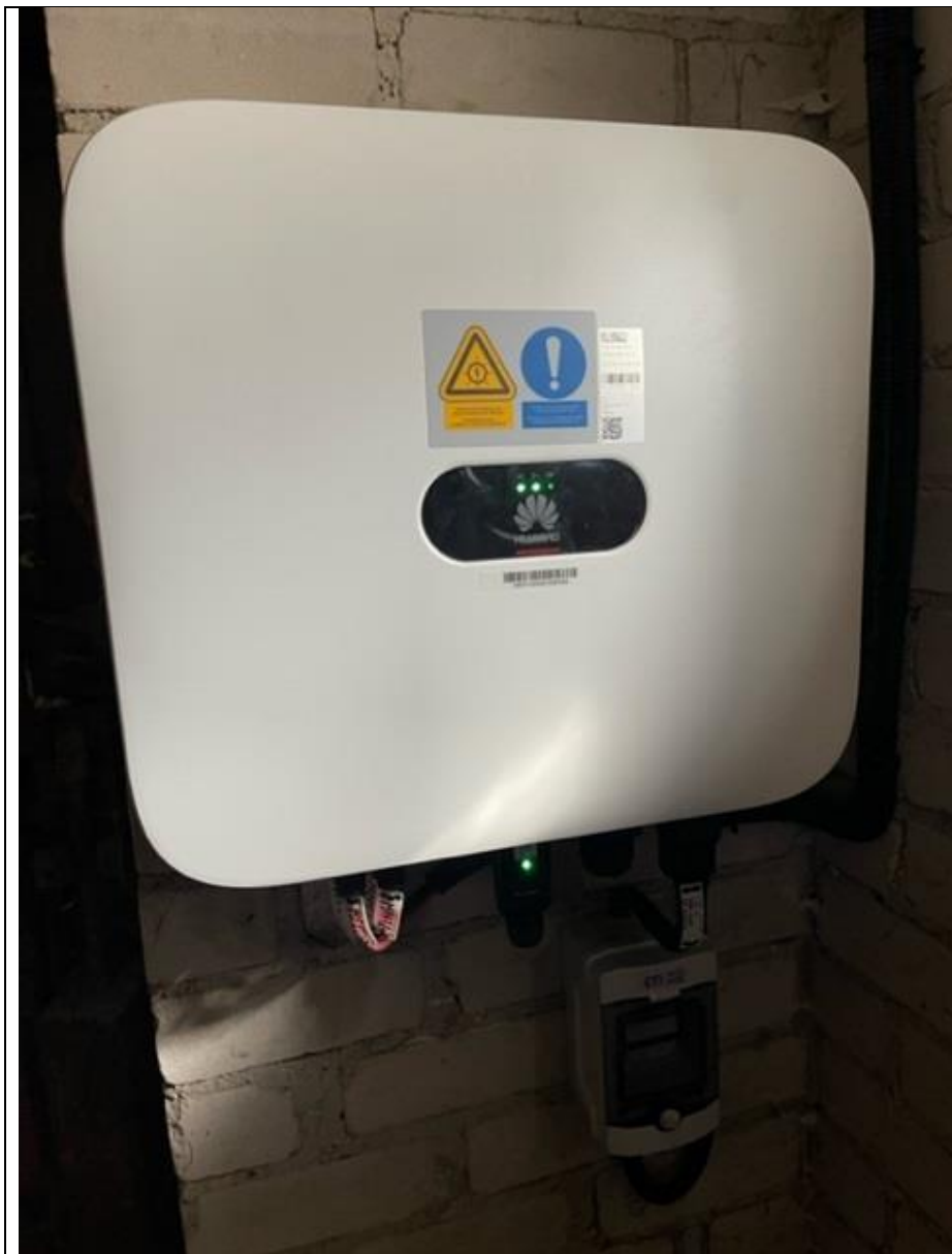
Pav. 2. 10 kW DC į AC inverteris (namo viduj, paprastai rūsyje).
