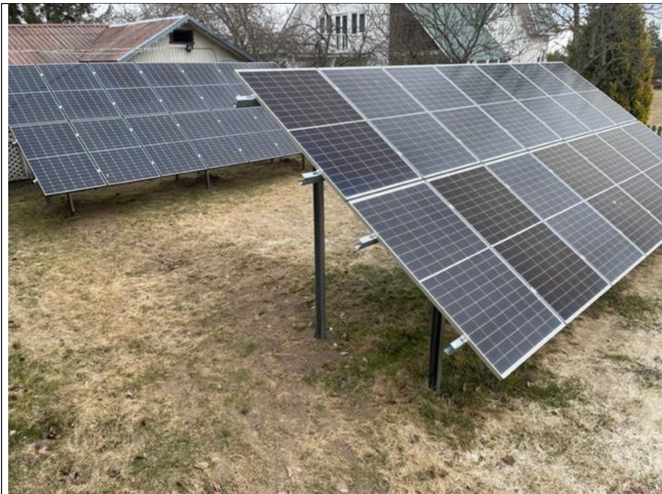
Pav. 1. 10 kW saulē elektriskās paneļs (2 bloki po 14 paneļu, ~1 aras).
